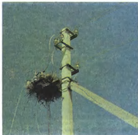
Гнездо на опоре электрелинии — не такая уж и редкость.
